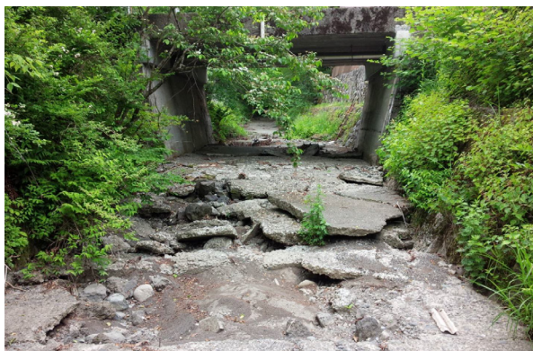
二の堀 損傷状況
