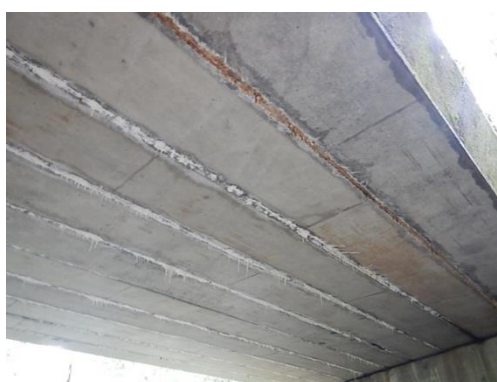
間詰部からの遊離石灰の析出
