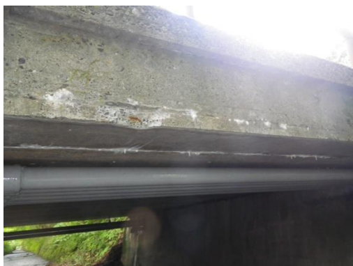
コンクリート桁のはく離・鉄筋露出
