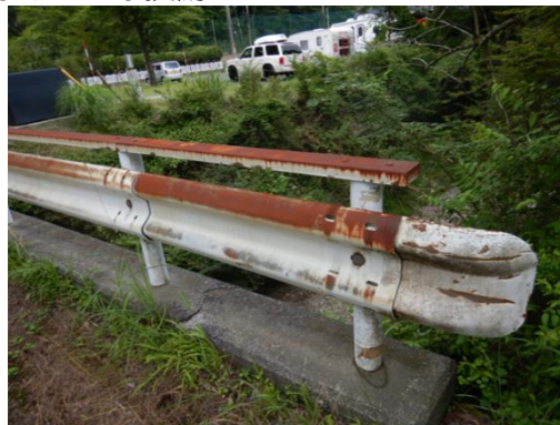
防護柵のボルト脱落
