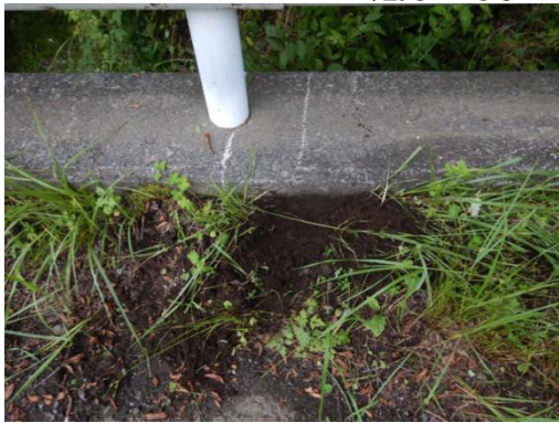
排水施設の土砂詰り
